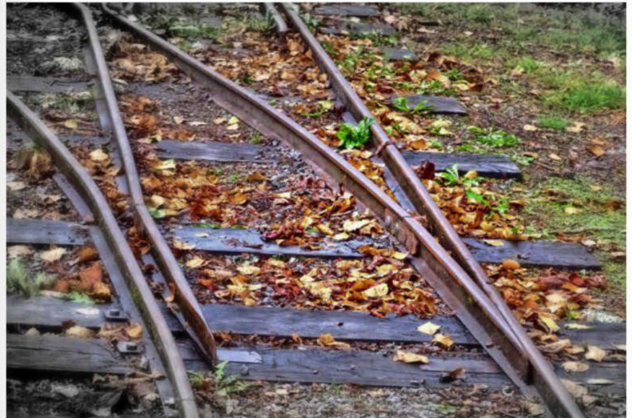
Weiche einer Lorenbahn September 2018
